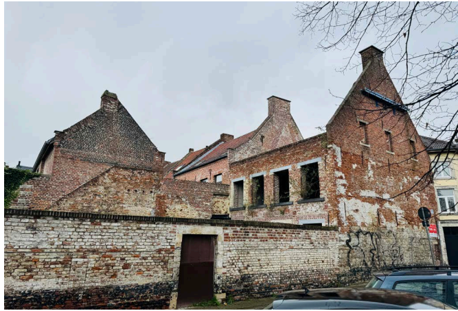
Foto vervallen woning met erfgoedwaarde
